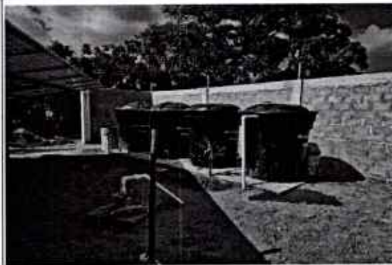
Descripción Registro Fotográfico: : pozo profundo el Coley-Los Palmitos.
